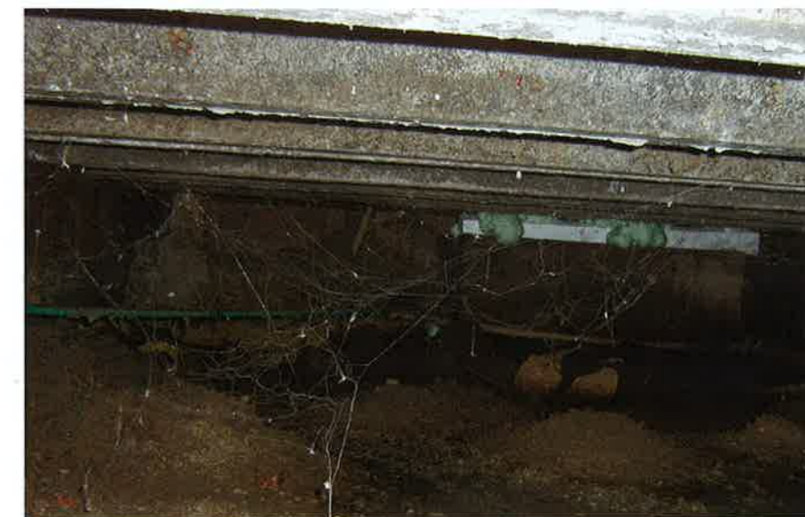
Een wirwar van leidingen en rommel in de kruipruimte.
